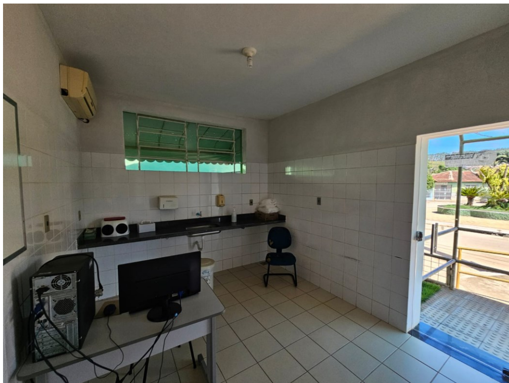
Foto 03: Vista interna da sala que receberá a reforma para implantação do ultrassom;
