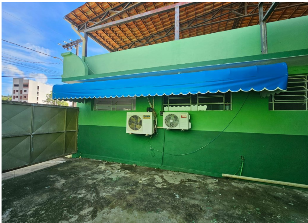
Foto 06: Vista da área externa onde será realizada a remoção dos ares condicionados para construção do banheiro acoplado a sala de ultrassom e posteriormente serão reinstalados os ares e também o toldo;
